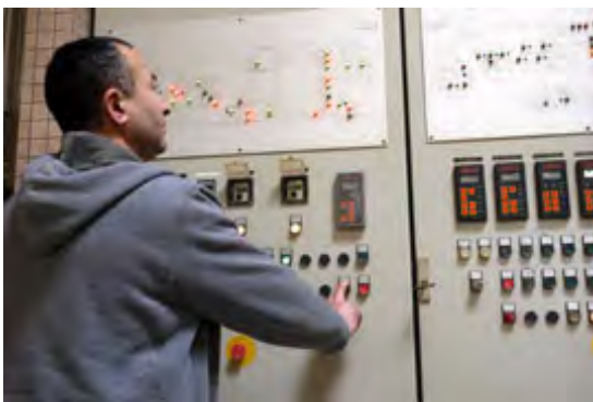
Bild 3: Am Schaltschrank wird die Bearbeitungszeit eingestellt.
